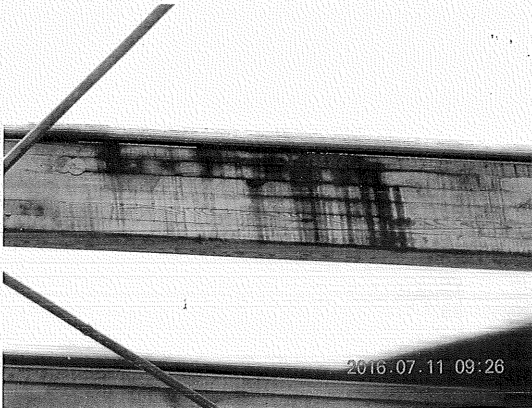
Fot. 7. Jeden z licznych przykładów biokorozji tężników przez glony. Widoczne jest również rozklejanie warstw elementu.
