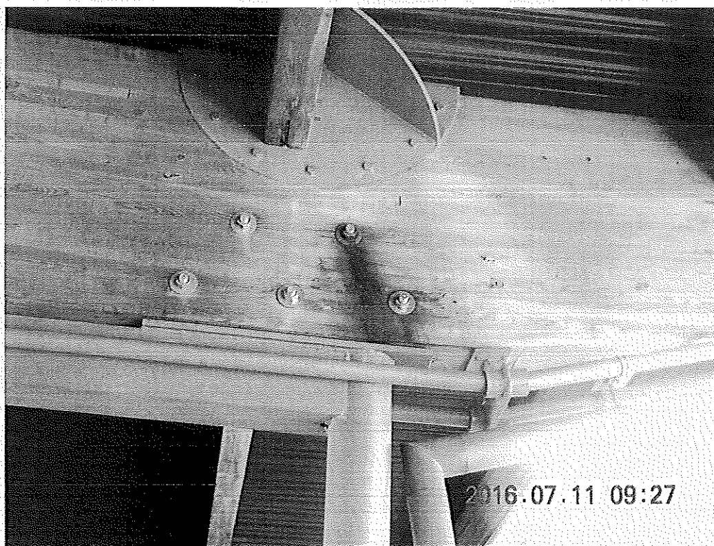
Fot. 10. Przykład strefy licznych przecieków wody- miejsce zamocowania płatwi i naciągu na dźwigarze. Widoczne zielone naloty glonów oraz korozja śruby.
