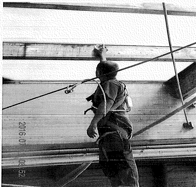
Fot. 9. Pobór jednej z kontrolnych próbek kontaktowych na tężniku. Tężnik ze śladami ociekania wody i zielonymi nalotami glonów.
