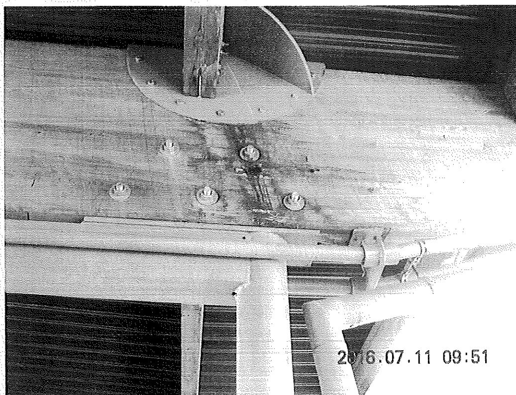
Fot. 12. Miejsce zamocowania płatwi i naciągu na dźwigarze. Na dźwigarze występują ślady ociekania wody, zielone naloty glonów oraz biała grzybnia grzyba składowego.
